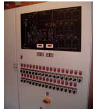
Schaltschrank mit Fließplan
